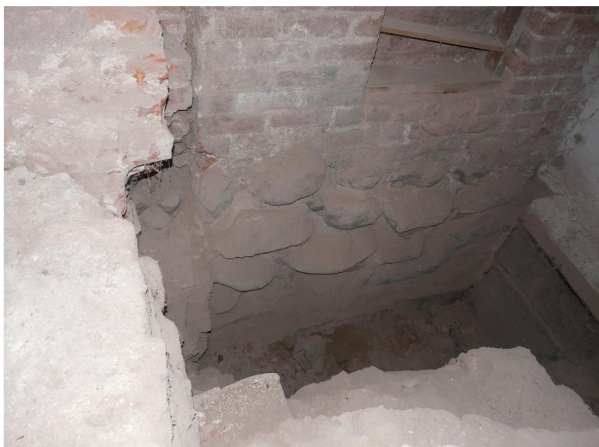
Fragment ściany południowej na poziomie piwnicy. Zabrudzona powierzchnia.
