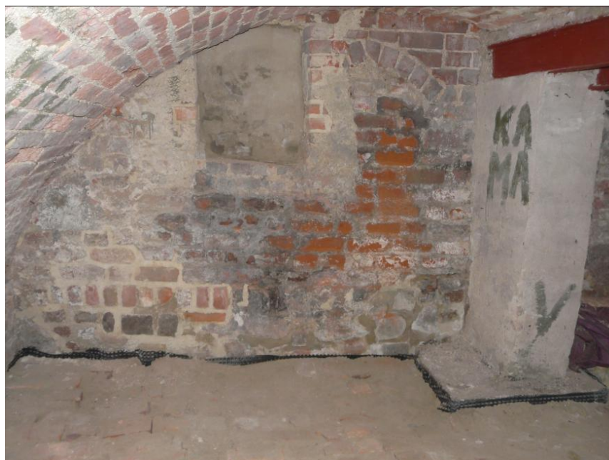
Ściana południowa z resztki tynków, wykwitami solnymi na cegle i licznymi przemurowaniami. Na słupie widoczne napisy.
