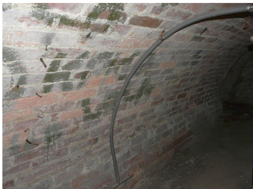
Fragment ściany zachodniej z napisami i cegalami z ubytkami w licu. Ubytki w spoinach. W spoinach żelazne gwoździe.
