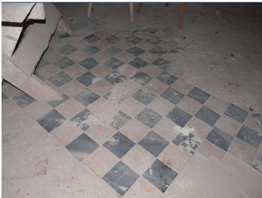
Płytki popękane i zbrudzone.
