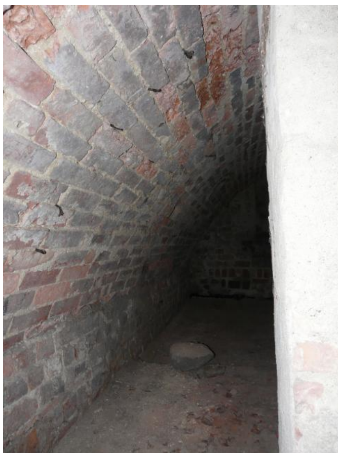
Ściana i fragment sklepienia z żelaznymi gwoździami w spoinach , skorodowaną cegłą i powierzchniowym zabrudzeniem. Na powierzchni muru widoczne wykwity solne.
