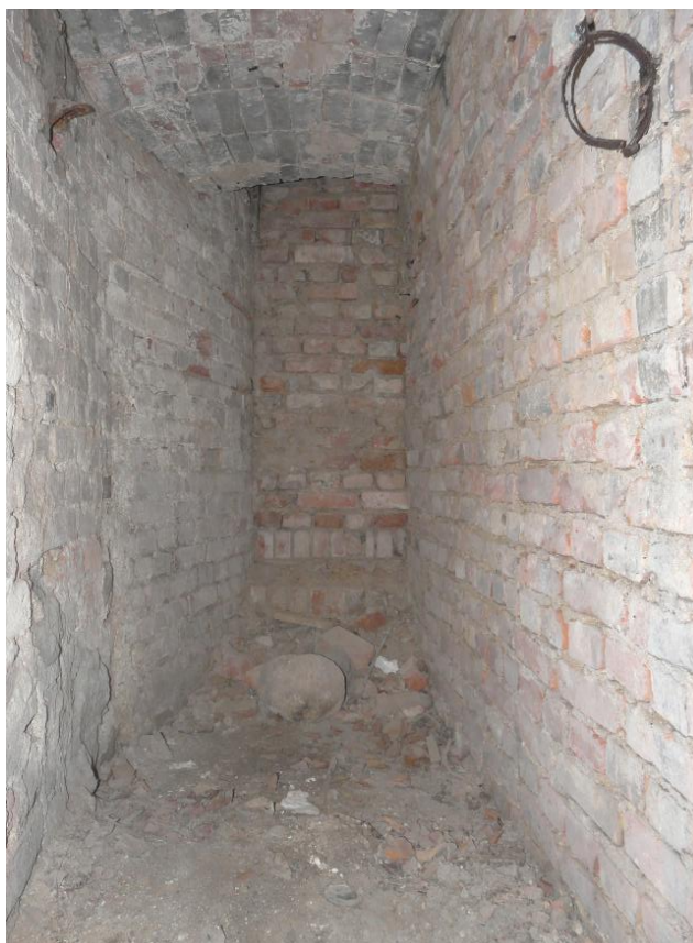
Ściany piwniczne zabrudzone resztkami zaprawy tynkarskiej, z przemurowaniami.
