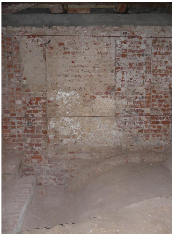
Trakt tylni z zamurowaną blendą, resztkami tynków.
