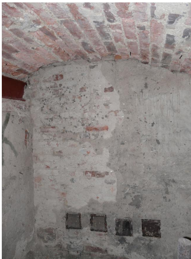
Fragment ściany z resztkami osypującego się, zwietrzałego tynku. Powierzchnia ściany zabrudzona.
