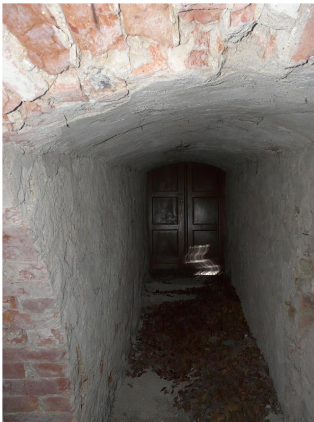
Wejście do piwnicy z zachowanym fragmentem tynku. Cegły w łuku silnie zwietrzałe.
