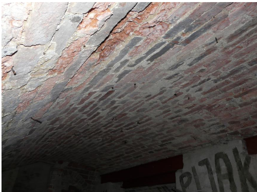
Sklepienie ze silnie zniszczonymi ceglami
