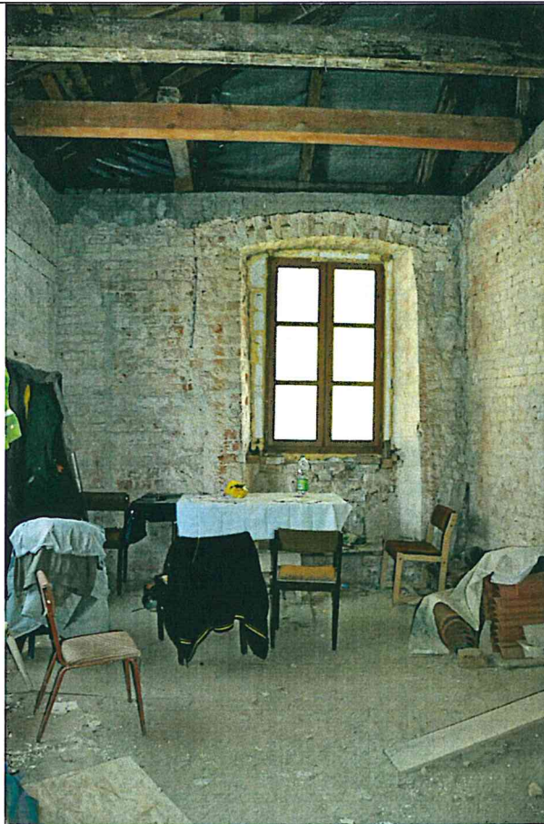
Fot. 6 Wnętrze dworu Kleista. Pomieszczenie w północnej, dobudowanej części budynku. Parapet pod oknem wymagający wymurowania na nowo.
