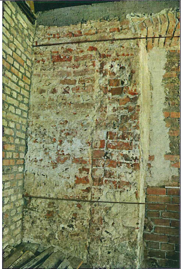
Fot. 8 Wnętrze dworu Kleista. Ściana południowa budynku, środkowa partia ściany. Widoczna partia historycznego muru, o przebiegu prostopadłym do ściany dworu, o skutym licu cegły.
